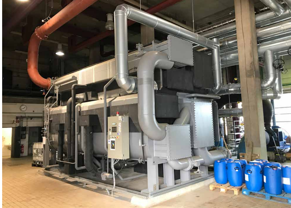
HKW Gießen Kältemaschine Bild: Stadtwerke Gießen AG
