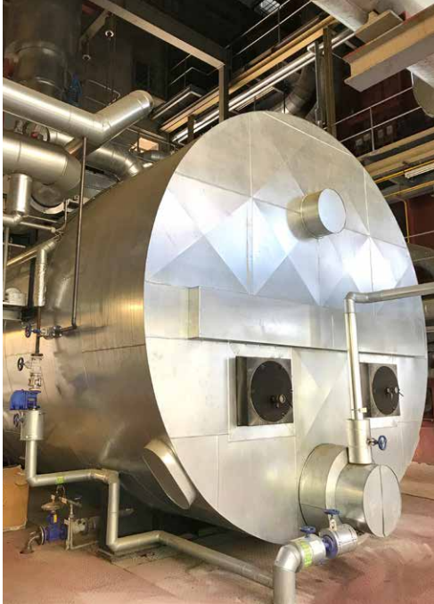
HKW Gießen Kältemaschine Bild: Stadtwerke Gießen AG
