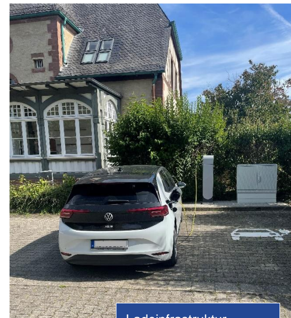
Ladeinfrastruktur Amtsgericht Fritzlär
